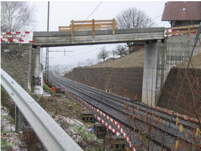
Das fertige Bauwerk, noch ohne Begrünung. Die Bahntrasse befindet sich bereits im zweigleisigen Betrieb.
